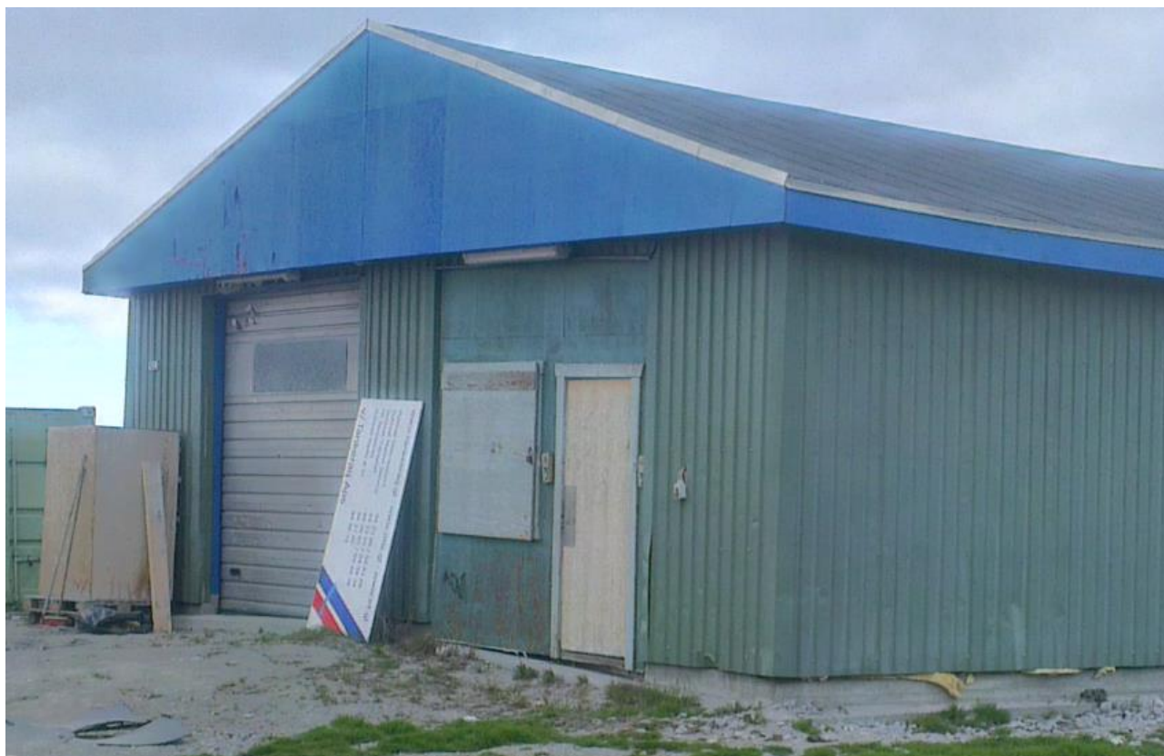
Figur 6-15 Det ses tydeligt at pladefunderingen er knækket
