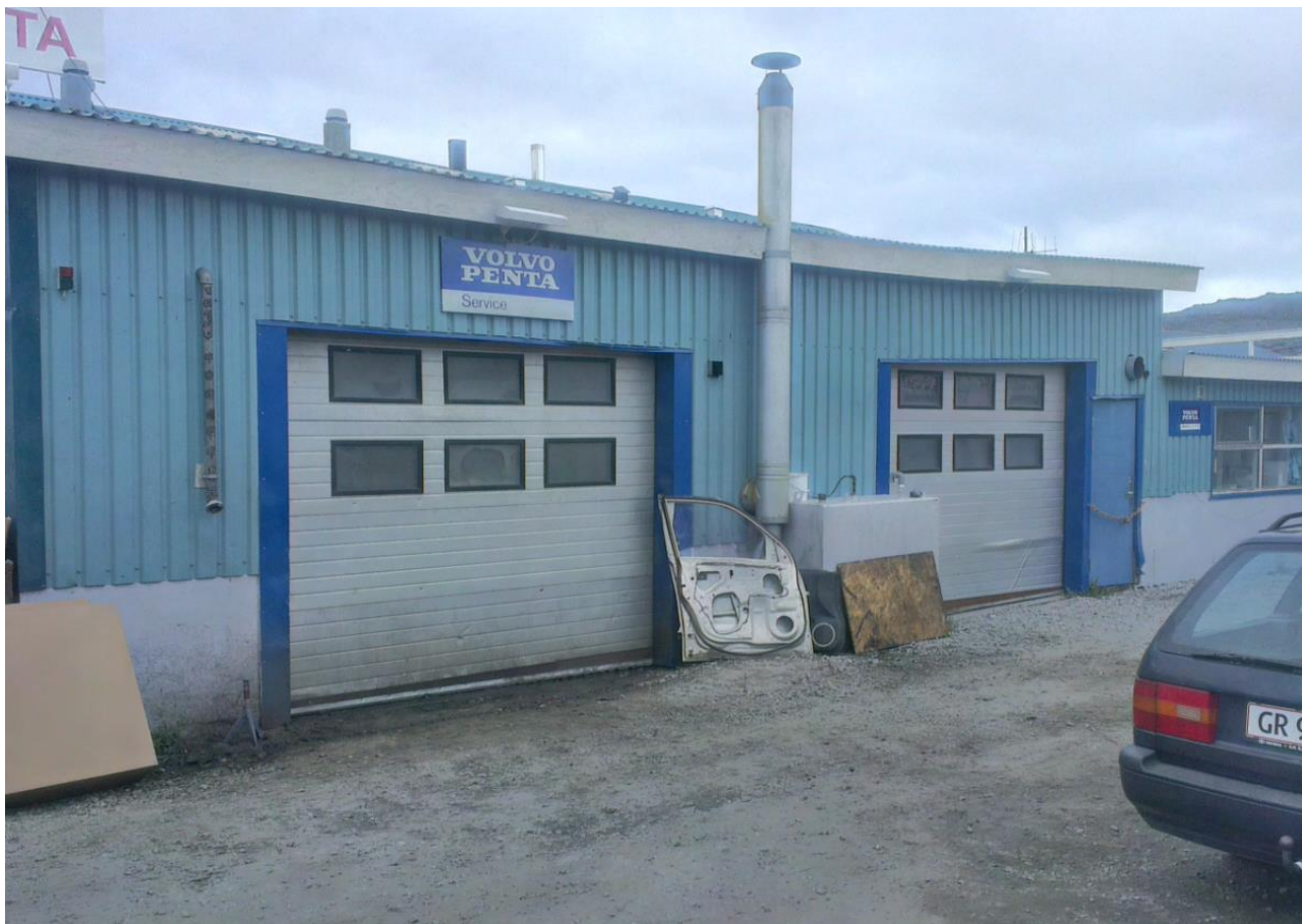
Figur 6-18 Sætninger på det lokale Toyota værksted
