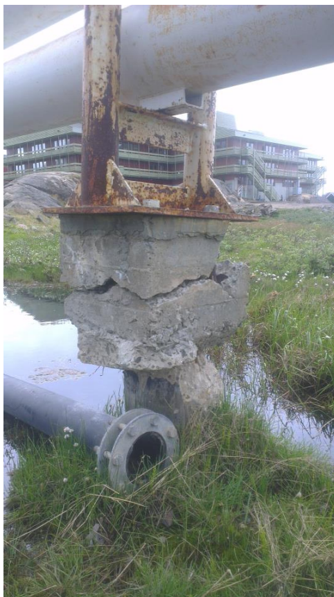
Figur 5-5: Fjernvarmerør funderet over terræn, fundamentet er trukket over grundet flytninger jordlaget [billede taget under observationer i Sisimiut]
